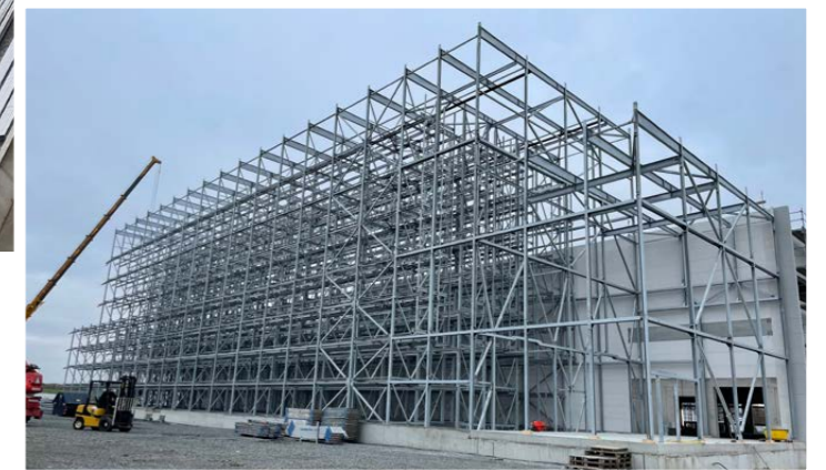
Aufbau des Hochregallagers
